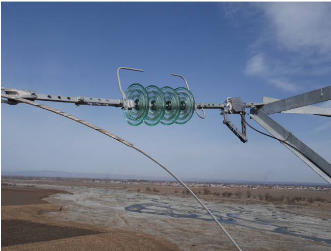
Рис. 2. Датчик ОДТиТ-7, установленный в натяжное крепление ОКГТ
