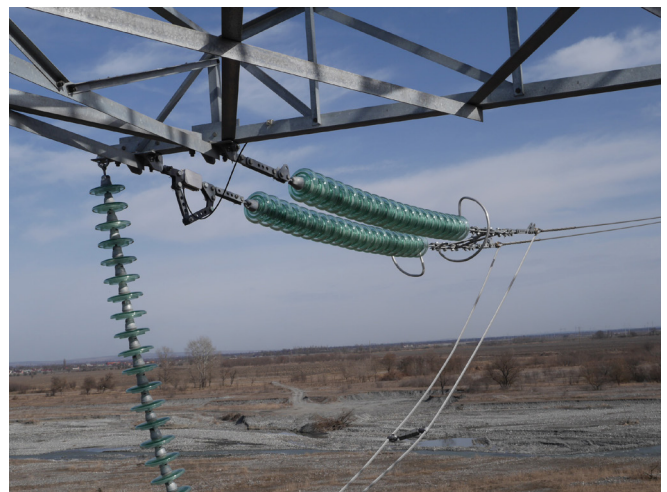
Рис. 3. Датчик ОДТиТ-16, установленный в натяжное крепление фазного провода
